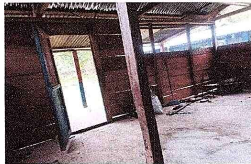
Foto 4: puerta en mal estado
